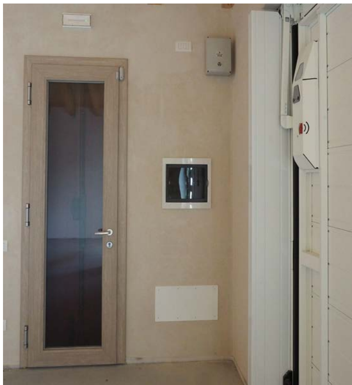
Vista interna garage con Kit BoxAlarm
